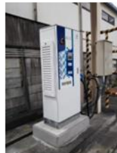
急速充電設備
