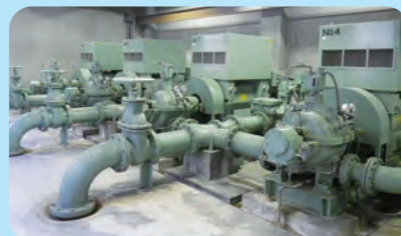
そうすい ●送水ポンプ
